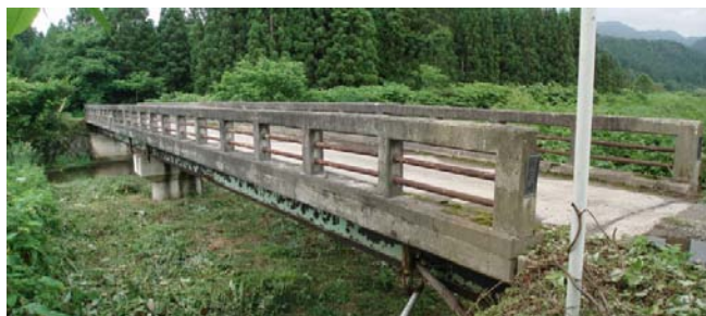
写真 5-1 コンクリート製防護柵
